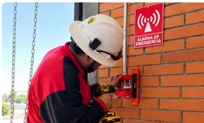
Sistemas de detección y alarma de incendios
