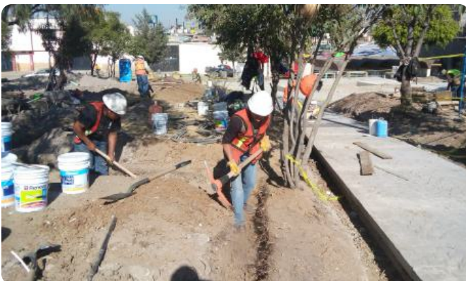
Infraestructura alumbrado público.
